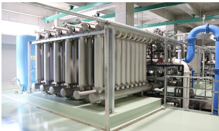
横瀬浄水場（膜ろ過施設）
